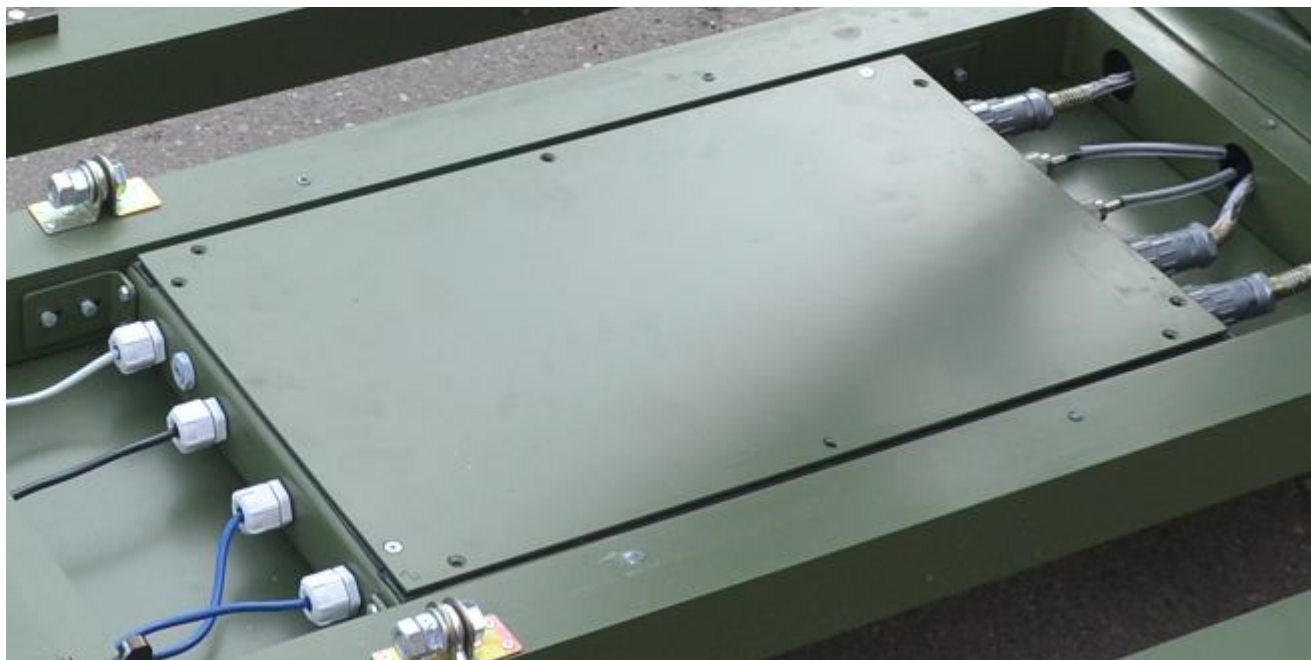
Рисунок 1.2.7 - Внешний вид БСНС ТИШЖ.468383.014, установленного на антенне
